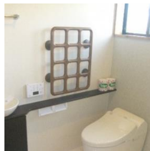
写真12. トイレ設置例2
