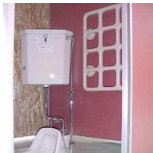
写真 13. トイレ設置例 3
